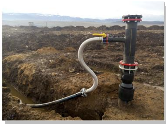
Figura nr. 4 – Capul special de puț de gaz, record flexibil inox și conducta transportoare
