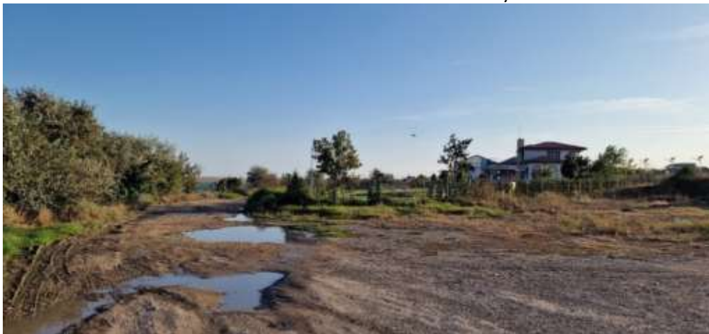
Fig. 5. Starea actuală proastă a drumul de acces de pe marginea lacului, pe care va fi edificată pista pentru biciclete
