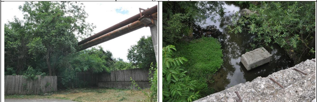
Fostele estacade a conductelor de hidroamestec din satul Șotânga
