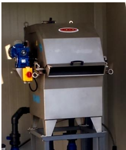
Figura 11 Instalatia automata de sitare
