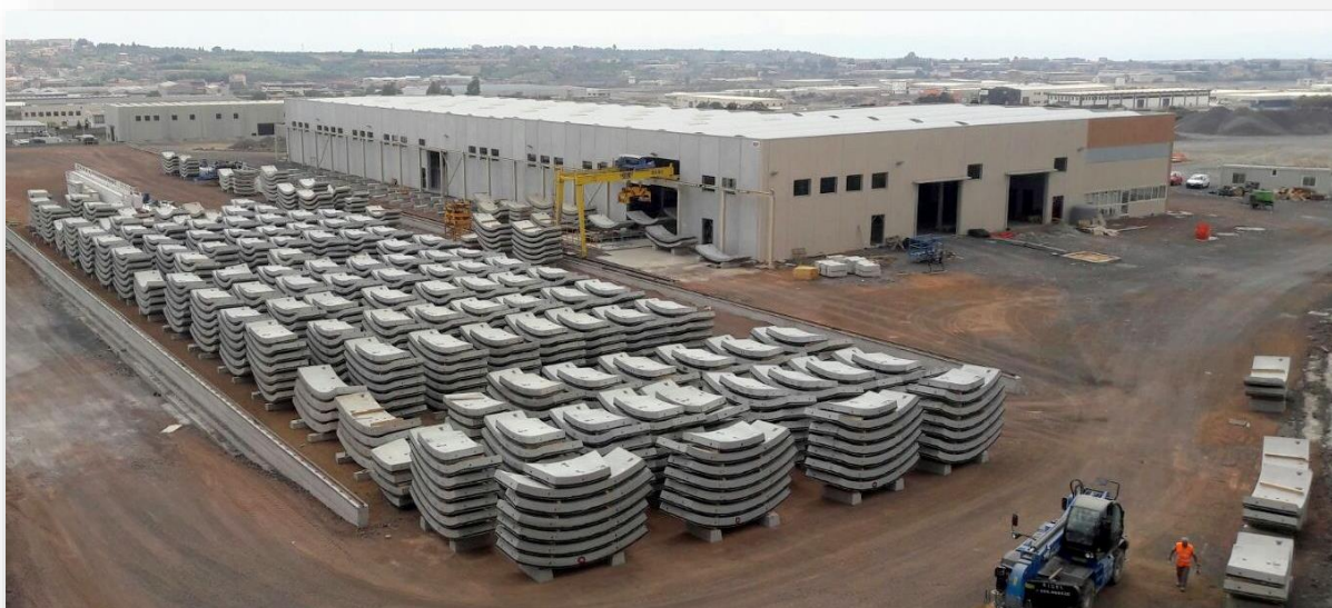
Figura 1.151. Zona de depozitare a segmentelor prefabricate de inel.
