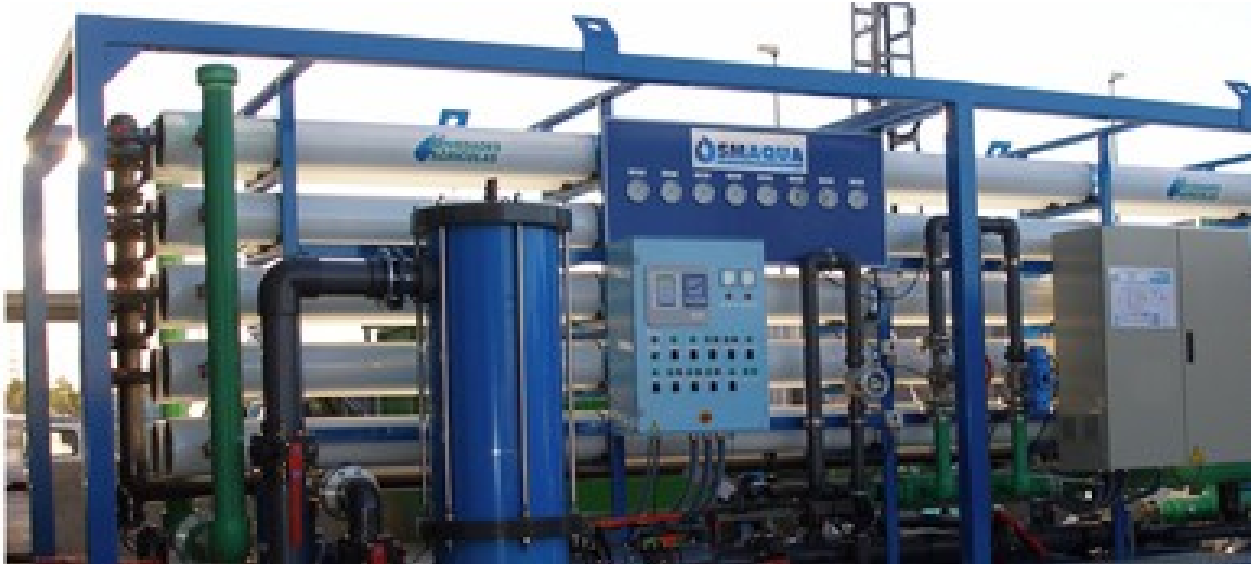
Fig.19.Instalația OSMAQUA ce se bazează pe procesul natural de osmoză
