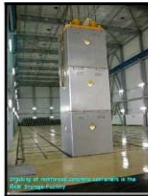
Figura 5 Containerе бетон армат pentru stocarea deseurilor radioactive in cadrul DNDR
