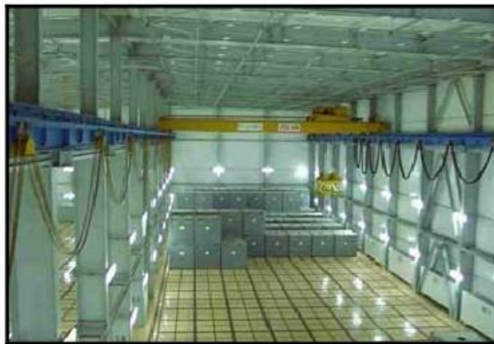
Figura 6 Stocare temporara in depozitul de la Centrala Nucleara Kozloduz
